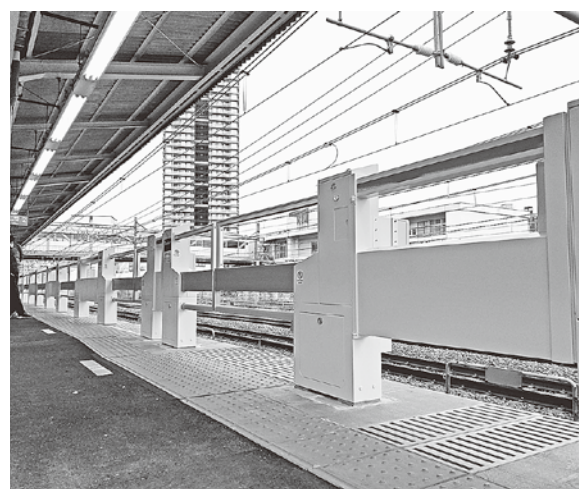
蕨駅に設置されたホームドア
